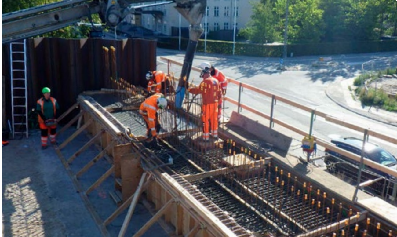
I 2020 har letbaneprojektet haft et stort fokus på sikkerhed. Det har resulteret i, at projektet per 31. december 2020 har haft 492 dage uden ulykker med fravær.
